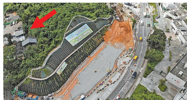
蠔涌車公廟側的西貢公路2019年進行擴闊工程，莊匡文指廟宇受附近工程影響，神力也減弱。圖為2019年5月情況。箭咀所指為車公廟。 路政署圖片
