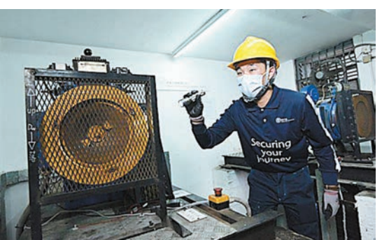
升降機工程公司在升降機梯安裝感應器，以5G傳送數據，一旦情況異常即派員檢查。
