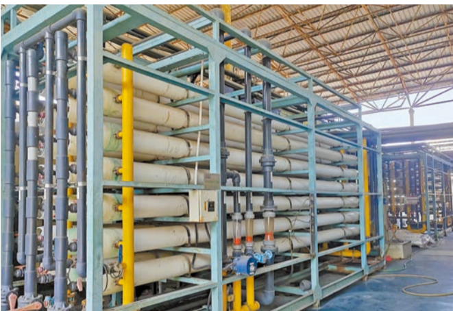
恩達集團致力改善污水措施，圖為廢水反滲透處理系統。
